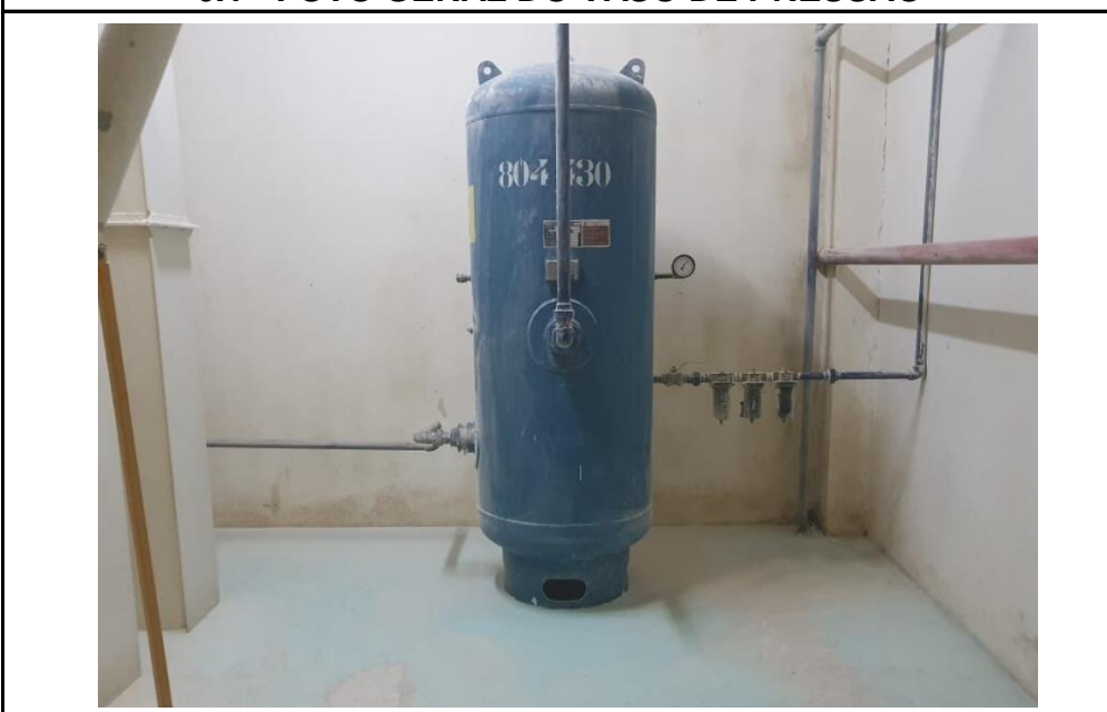
6.1 - FOTO GERAL DO VASO DE PRESSÃO
