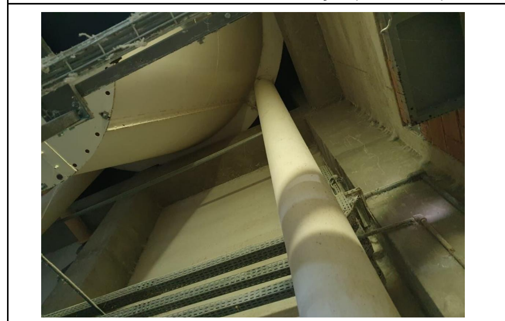
6.4 - FOTO DO AMBIENTE DE INSTALAÇÃO (LATERAL H1)
