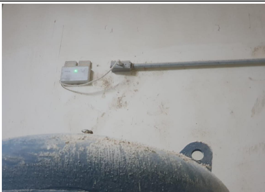
6.7 - FOTO DA LUMINÁRIA DE EMERGÊNCIA
