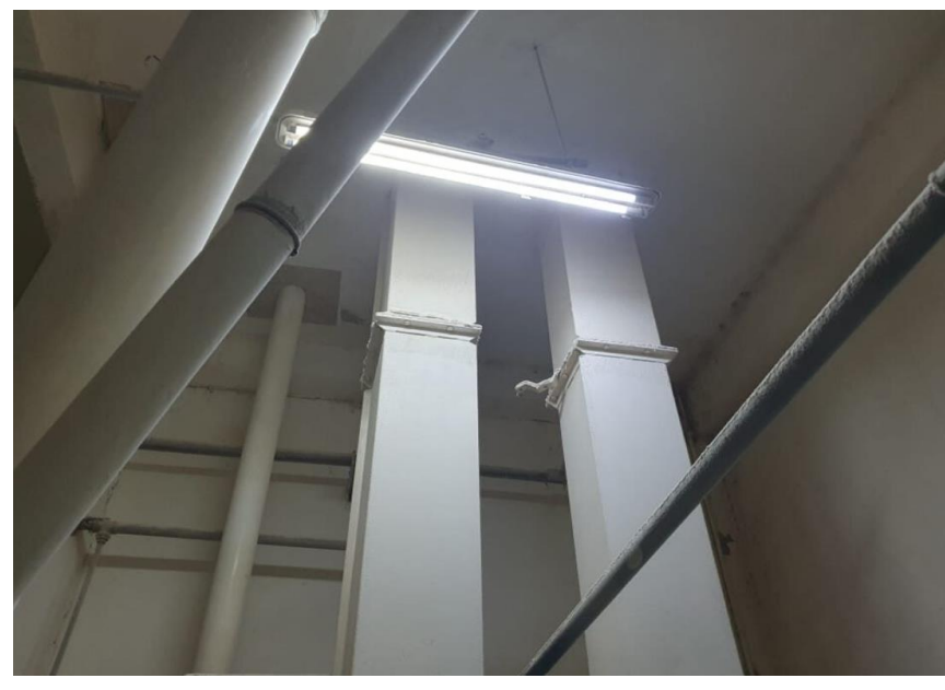
6.6 - FOTO DA ILUMINAÇÃO
